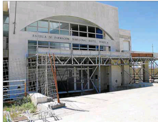
Lamentable estado del edificio del centro docente, cuya entrada está apuntalada. ■ Foto: J. MOREY
